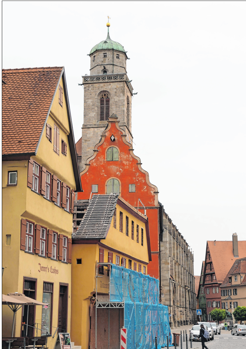
Die Brandruine in der Segringer Straße 4 soll abgerissen werden. Der Bauausschuss stimmte dem im Oktober zu. Dagegen wendet sich der Verein ProAltstadt jetzt mit einem offenen Brief. Foto: Martina Haas
